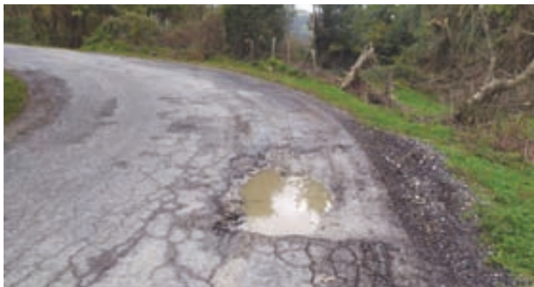
Estado no que se atopa esta vía
