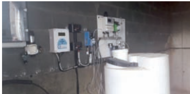
Un dos novos sistemas instalados nos depósitos de auga do Concello
