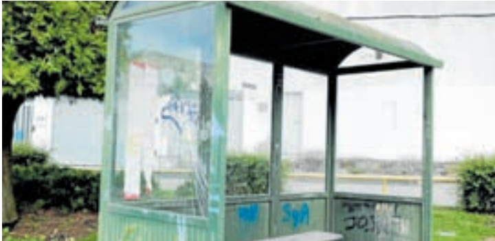
CASÁS. A Asociación de Veciños Oliveira Casás, integrada na Federación de Asociacións de Veciños Lucus Augusti, vén de expresar a súa preocupación polo estado de deterioración que presentan varias marquesiñas de autobuses urbanos no barrio de Casás. Por este motivo, solicitan unha intervención inmediata para reparar as estruturas danadas
